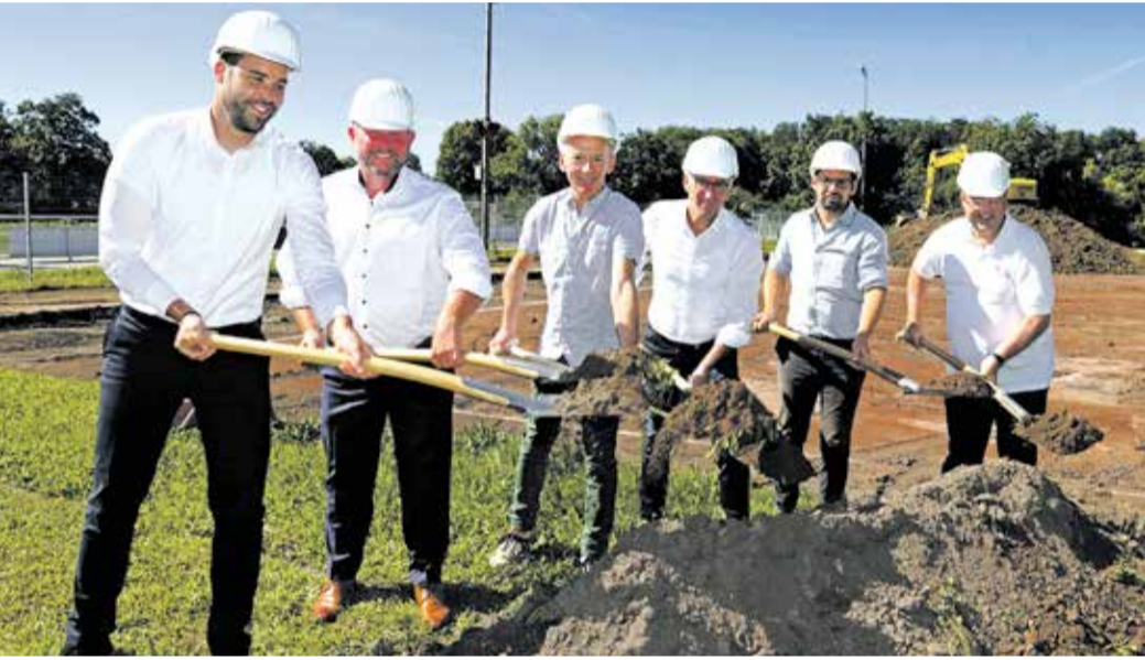
Zum Spaten griffen: Michael Steinmetz (Voba DA-Südhessen), Bürgermeister Marcus Kretschmann, Landrat Thomas Will, Gernot Hofmann (Vorsitzender TV Crumstadt), Architekt Christian Habermann und Udo Ahlheim, stellvertretender Sportkreisvorsitzender (von links). Foto: Stadt Riedstadt
