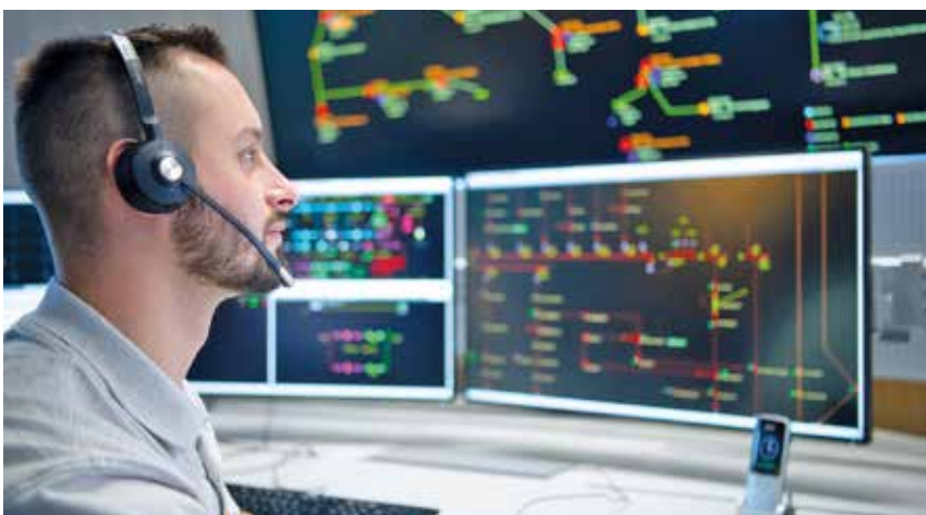
Schaltmeister in der Querverbundleitstelle der e-netz Süd Hessen bei der Kontrolle und Überwachung des Versorgungsnetzes
